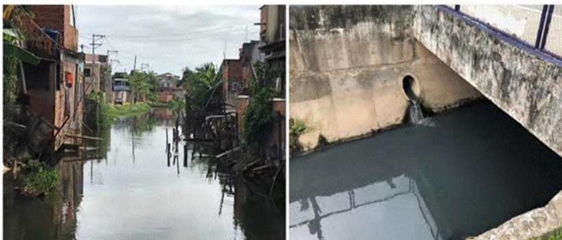
Figura 10 - Esgoto lançado in natura nas redes de micro e macrodrenagem Fonte: Prefeitura de Macaé (2025)
